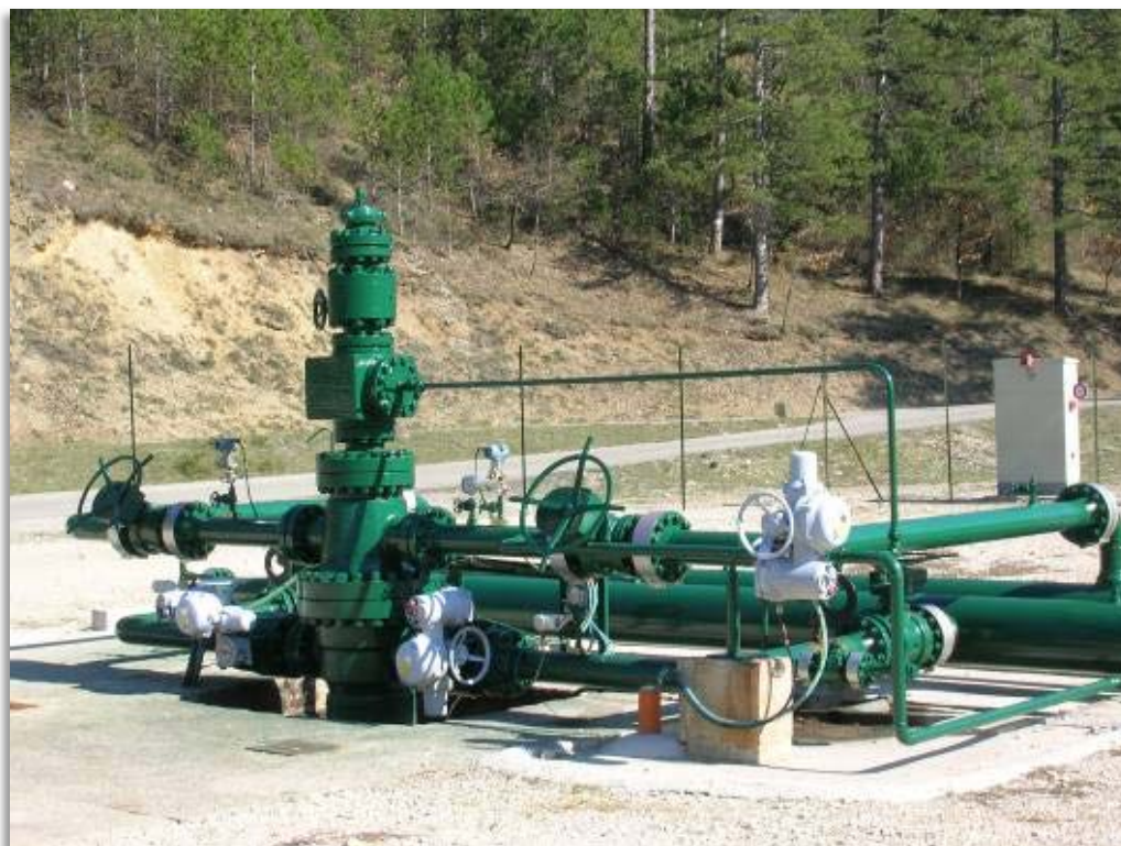
Figure 2 - GEOSEL - Tête de puits
